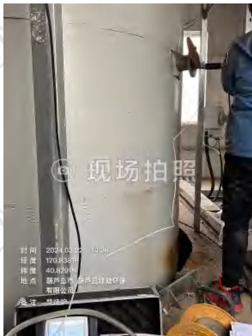
2#焚烧炉废气检测口
